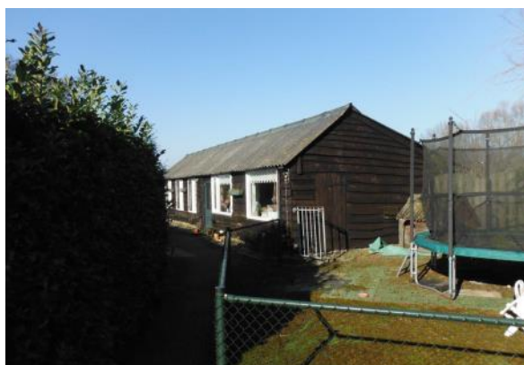
Foto 6: Noodwoning met asbestverdachte golfplaten (circa 96 m 2 )
