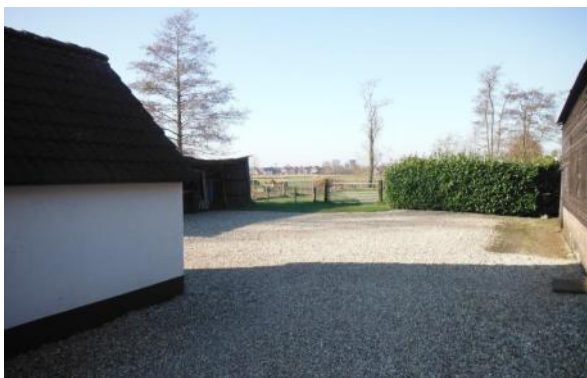
Foto 3: Erf met op achtergrond afdak met asbestverdachte golfplaten (circa 96 m 2 )
