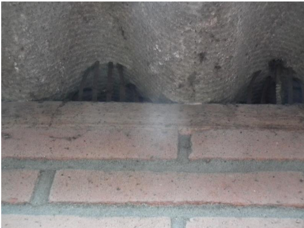
Figuur 4 De varkensstal is in het kader van hygiëne en isolatie ten aanzien van de varkenshouderij voorzien van vogelwerende middelen als vogelschroot.
