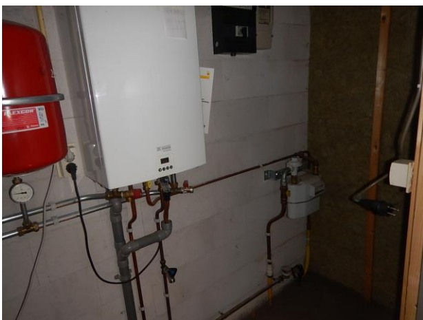
Schuur 2 cv-ketel niet asbestverdacht
