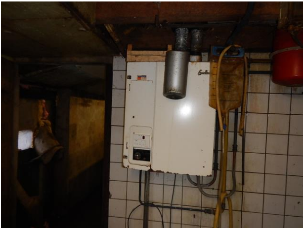
Cv-ketel schuur 1 niet asbestverdacht
