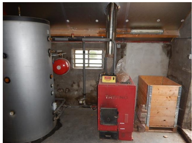
Bron 5 pakking in cv-ketel niet asbesthoudend (2)
