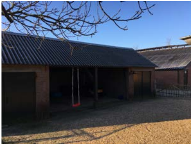
Foto 6: Voorzijde schuur 3 gezien in westelijke richting met het aanwezige asbestgolfplaten-dak met de ontbrekende dakgoot.
