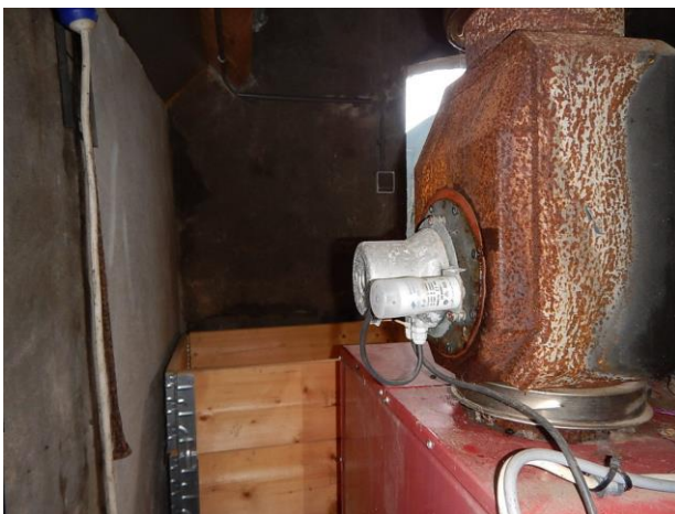
Bron 5 pakking in cv-ketel niet asbesthoudend
