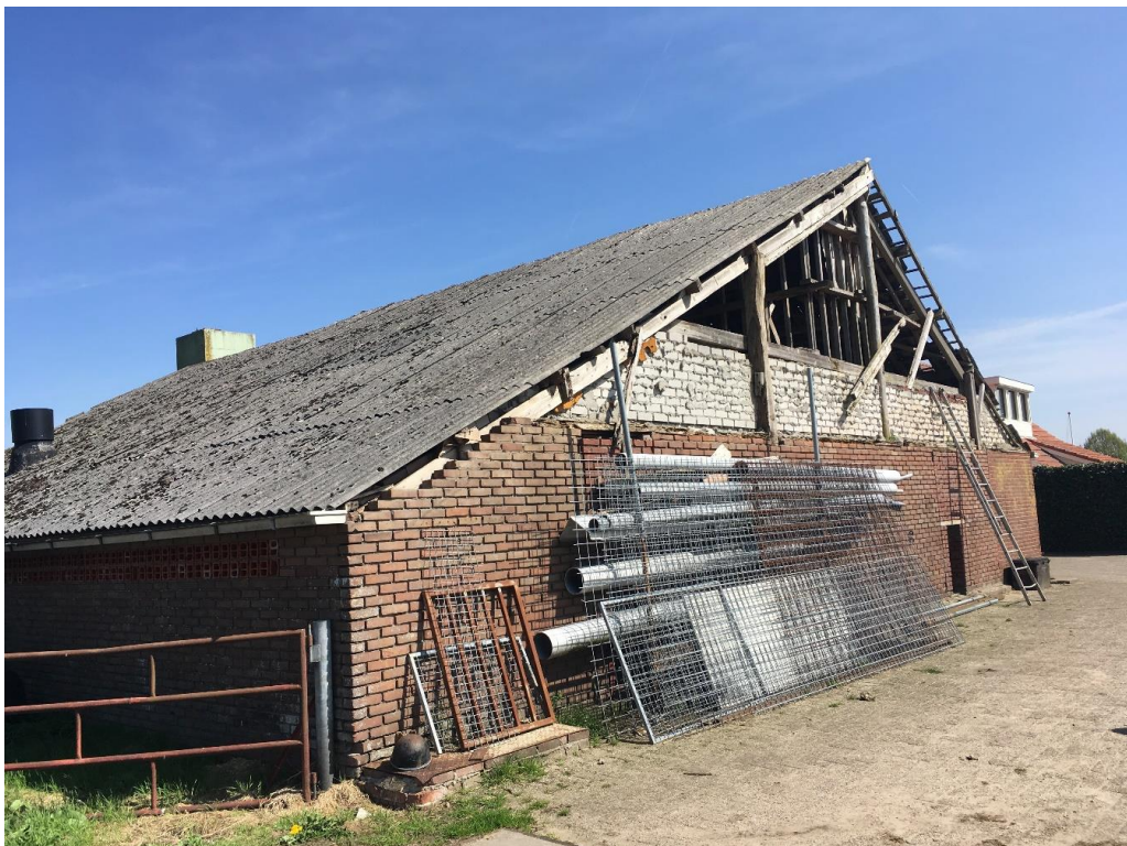
Figuur 2 De te saneren opstallen verkeren in een zeer vervalLEN staat van onderhoud.
