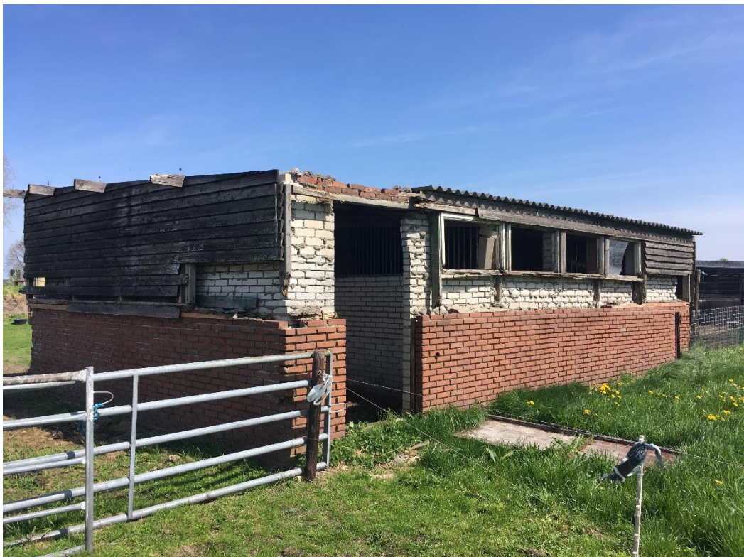
Figuur 4 Een van de te saneren opstallen betreft een oude paardenstal en is dermate vervallen dat een gedeelte van de gevels en een gedeelte van het dak weg zijn.
