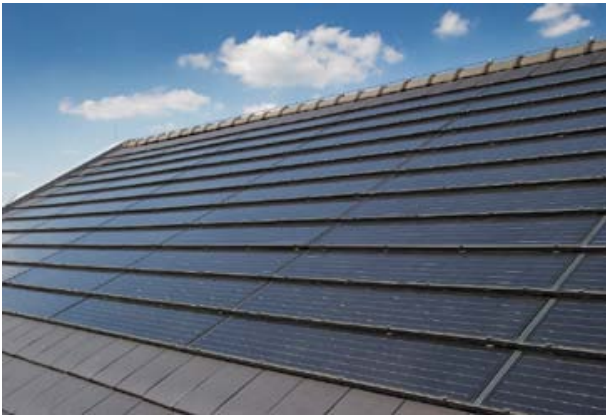
Fraai geïntegreerde zonnepanelen
