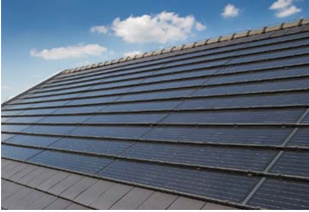
Fraai geïntegreerde zonnepanelen
