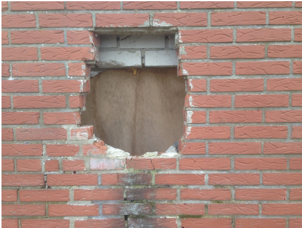
Figuur 4 Vanwege de gaten in de gevels is de spouw ongeschikt als verblijflocatie voor vleermuizen.
