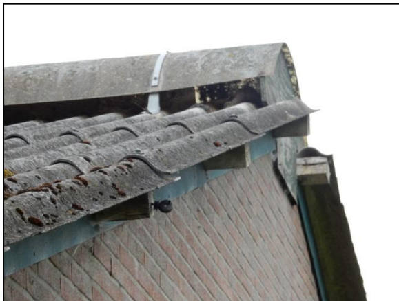
Figuur 13. De daklijsten sluiten strak aan de gevels aan. Er zijn daardoor geen toegangsmogelijkheden voor vleermuizen.
