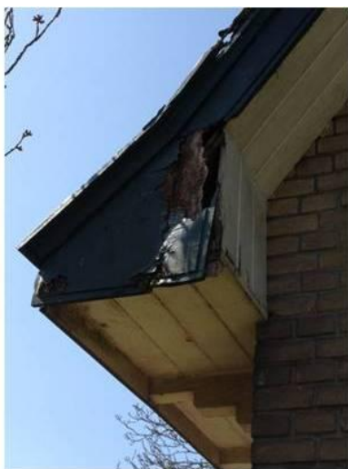
5. Opening in overstek, er zit geen ruimte tussen goot en gootbodem.
