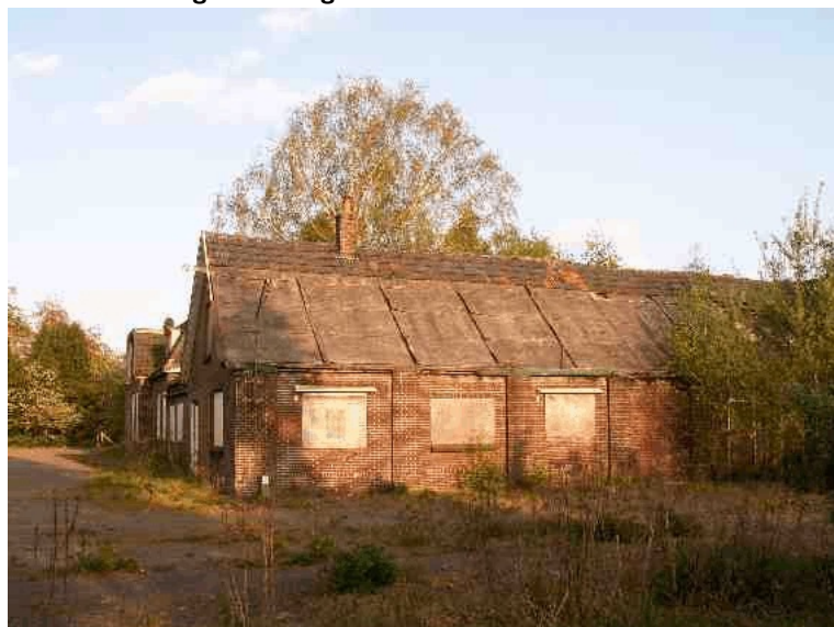
Het in verval geraakte gebouw B
