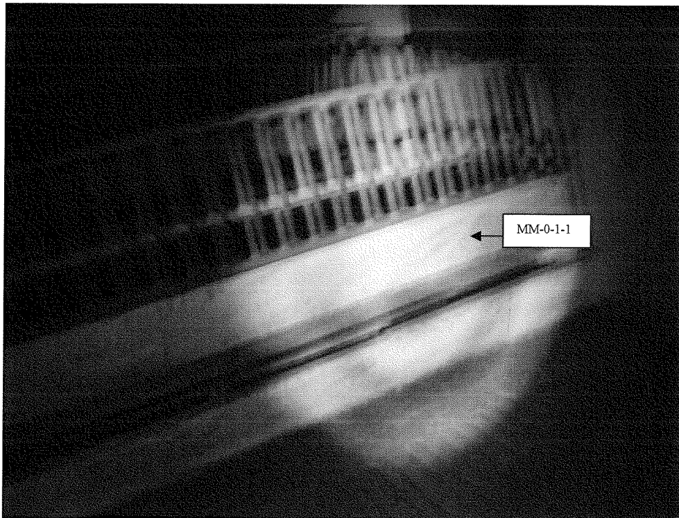
Foto 1: Asbesthoudend plaatmateriaal in ijzerenframe t.p.v. voerbak van varkenshokken.
