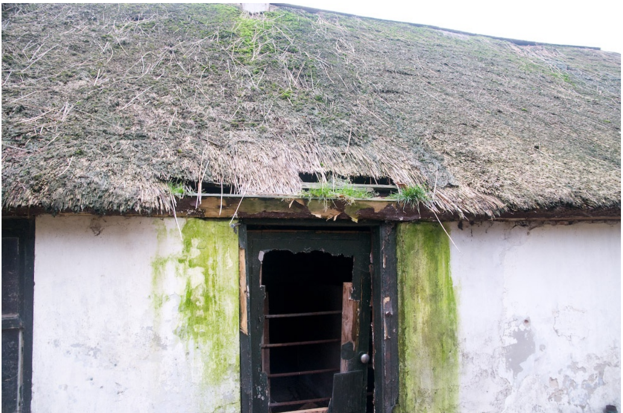
Er zitten grote gaten in het rieten dak.
