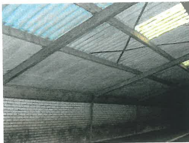
Strook asbest plaat in loopstal.
