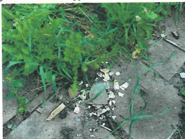
Asbestresten achter het woonhuis.
