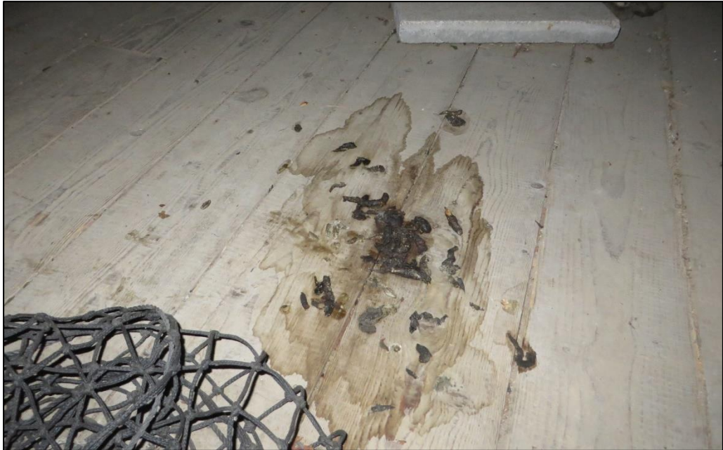
De aangetroffen uitwerpselen van de steenmarter op de zolder van het koetshuis. Foto: SAB, 2016.
