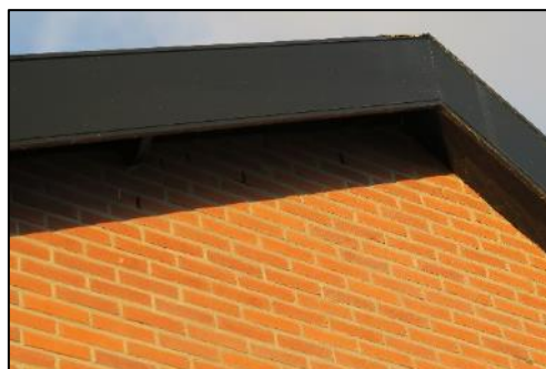
Foto 4. Westzijde woning Aalsdijk 2 met meerdere open stootvoegen
