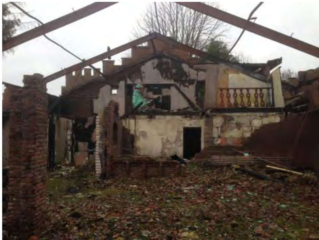
Figuur 2 Inpandige restanten van Fritsenburcht. Volgens nummering plattegrond; voor gevelmuur A, links gevelmuur B en rechts binnenmuur K (© Blom Ecologie).
