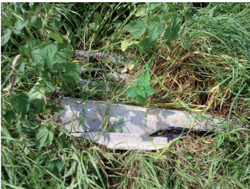
Foto asbestverdacht plaatmateriaal (foto 2 in bijlage 2)
