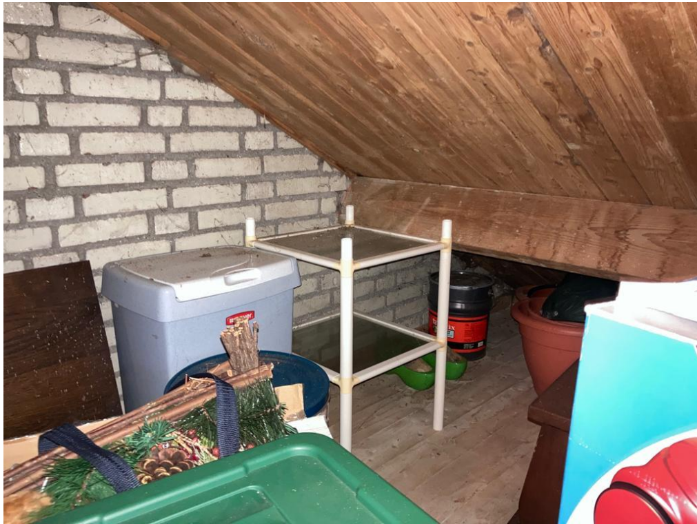
• Afbeelding 11: binnenzijde woonhuis (locatie zolder) met sporen lekkage
