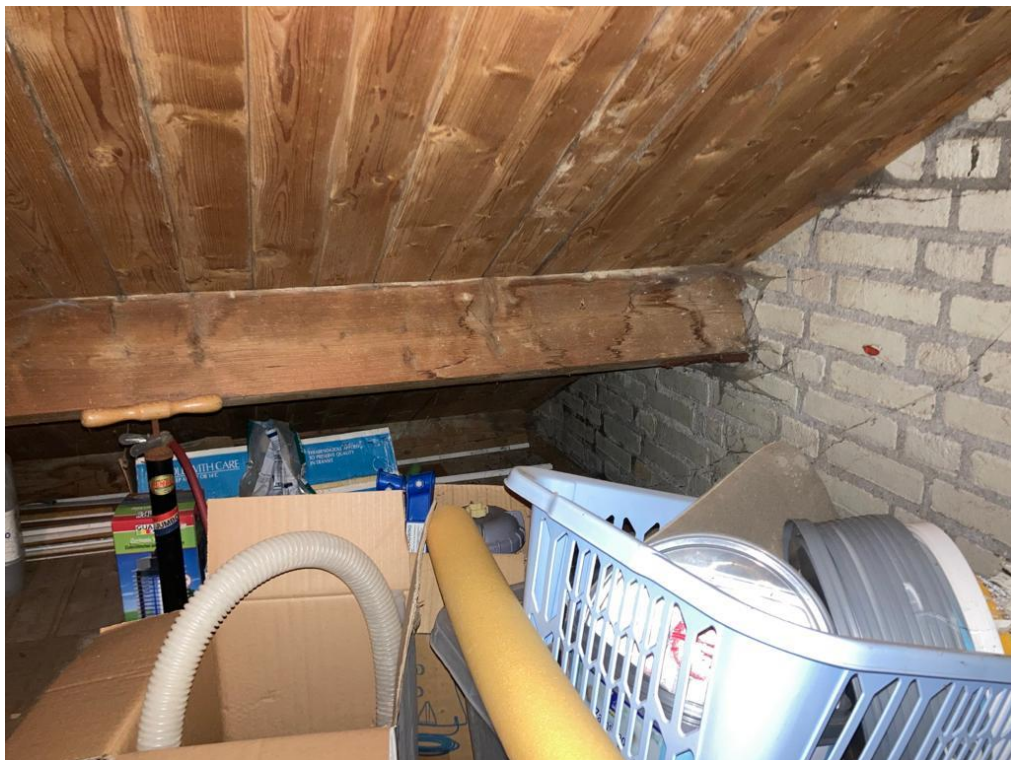
• Afbeelding 14: binnenzijde woonhuis (locatie zolder met lekkage)
