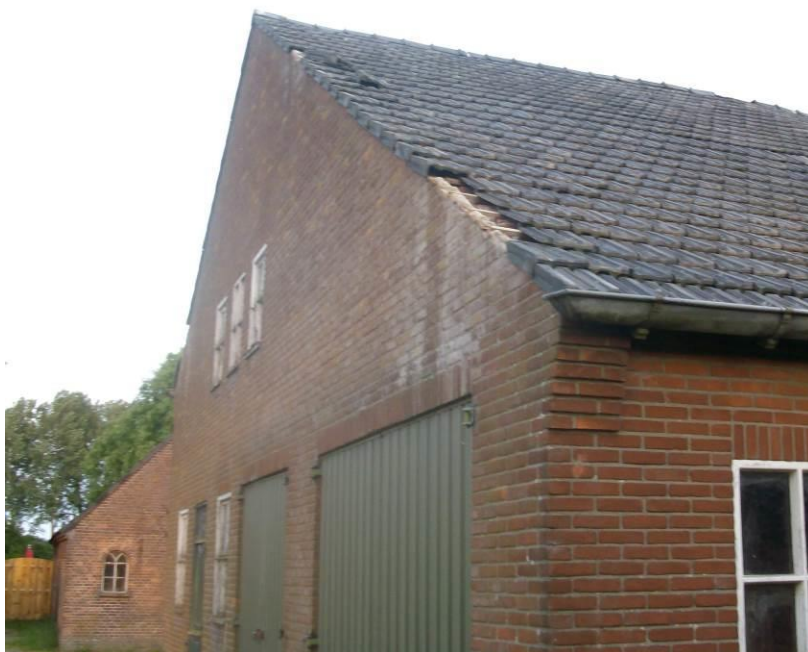
Figuur 4. Schuur waarvan enkele dakpannen ontbreken, waardoor spouwmuur zichtbaar is.
