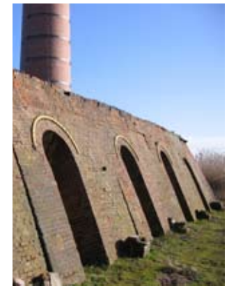
bestaande vlamoven met schoorsteen
