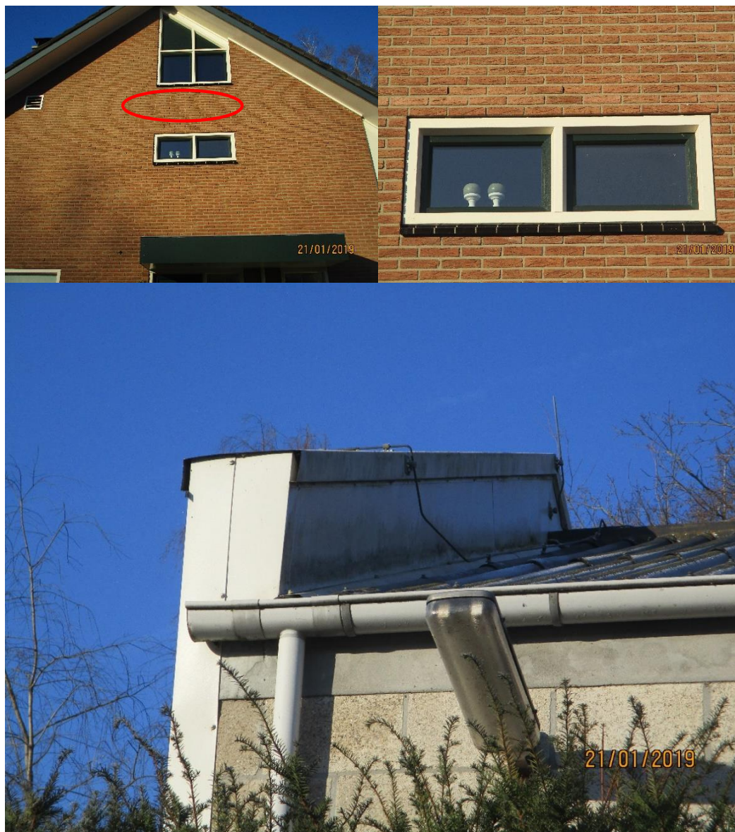
Figuur 1.2 Linksboven: Open stootvoegen in de gevel van de woning (rood omcirkeld). Rechtsboven: Close-up van de stootvoegen. Onder: Openingen in de tussenwand tussen de loodsdelen.
