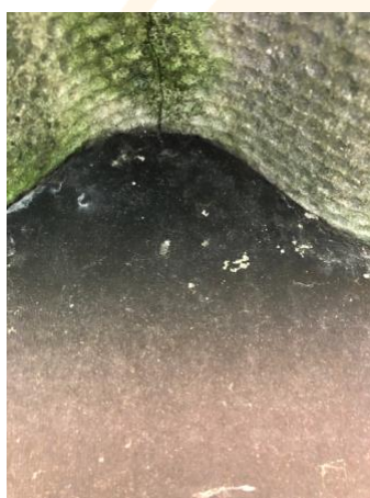
4a. afdekking met asbest
