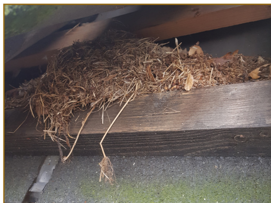
Afb. 2.17: Foto van opeenhoping van bladafval onder de dakpannen van de redelijk nieuwe schuur (1).
