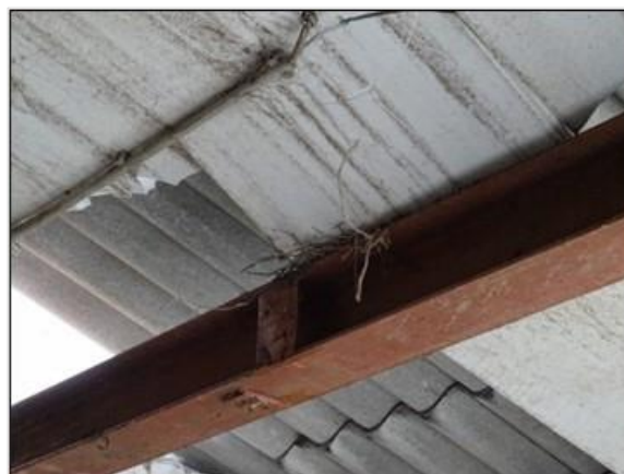
Figuur 5.8 Duivennest op een balk in de schuur.
