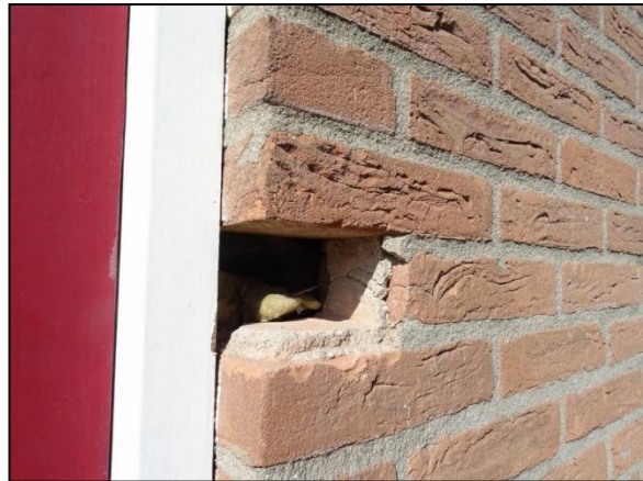
Figuur 16. De spouwmuur was op verscheidene plaatsen opengebroken.
