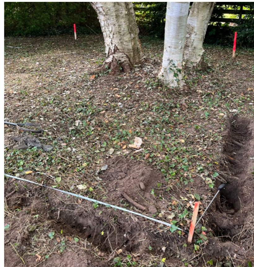
Aanbrengen van opsluitbanden t.p.v. de proefsleuven is niet mogelijk.
