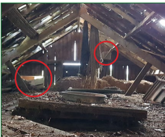
Afb. 2.11: Zolderverdieping gebouw 6. Links een beschadigde nestkast, rechts een kleine uilenkast die momenteel door spreeuwen gebruikt wordt. Door tocht en licht is het gebouw ongeschikt voor vleermuizen.
