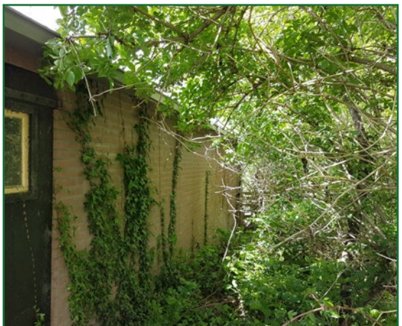
Afb. 2.12: Oostgevel pluimveestal, deels overwoekerd en tegen de groenstrook aan gelegen.
