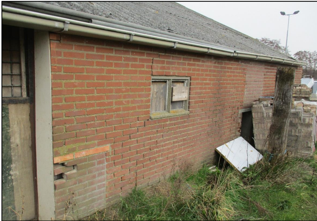
Figuur 4 De zuidelijke muur van gebouw 7 met één lage opening naar de spouwmuur. De scheur boven het raam betreffen enkel wat ontbrekend specie.
