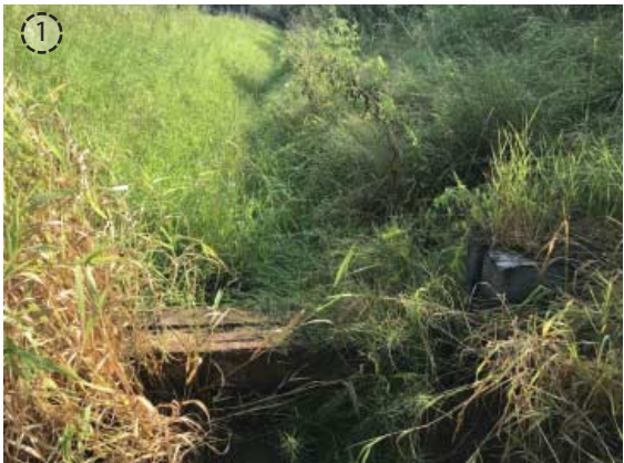
Huidige inrichting van de watergang: stuw
