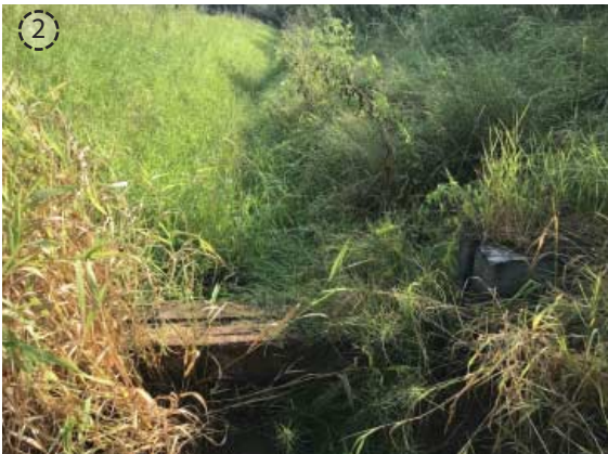
Huidige inrichting van de watergang: stuw
