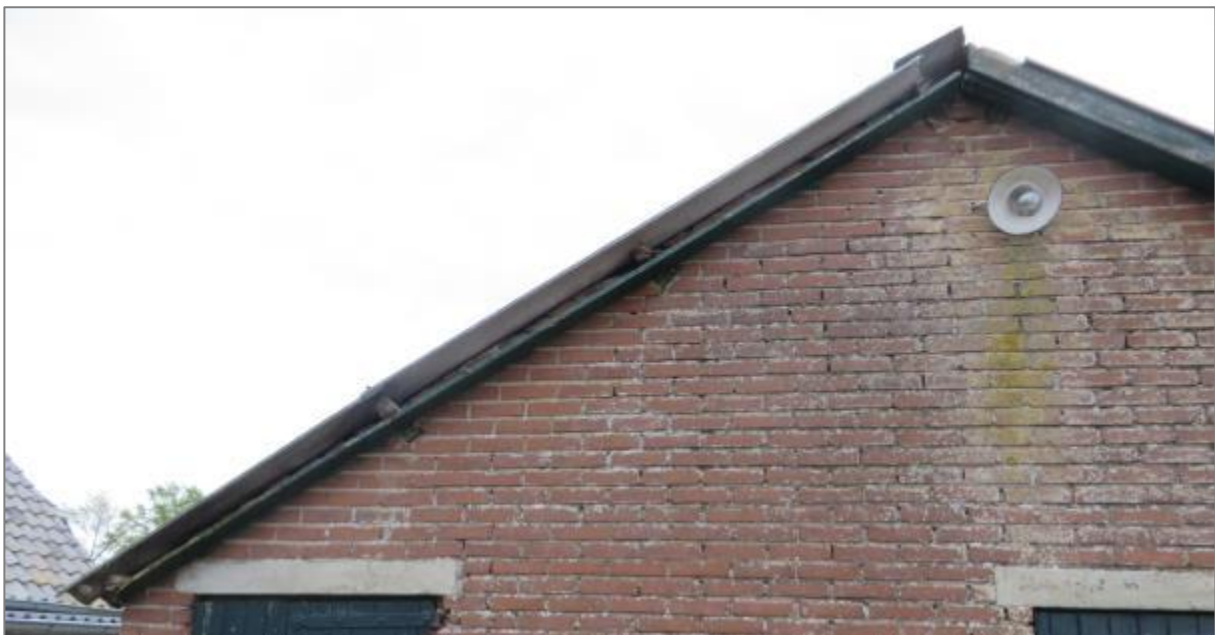
Afbeelding 5.1: Boven: Het dak van de oude stal, van binnenuit gezien. Onder: de dakbetimmering, waarvan delen ontbreken. Foto's: Natuurkompas, 2019.
