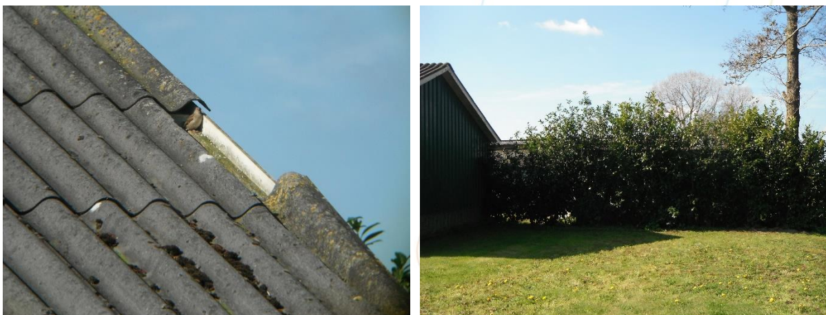
Figuur 6-1 de foto rechts toont een huismus in een kapotte asbestplaat op de kleine schuur (G1). De foto rechts toont de laurierstruik naast de kleine schuur die gebruikt als rustplaats door meerdere huismussen.
