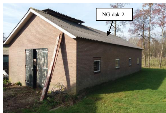
Foto 4: Geïntervieweerde schuur 2 met asbesthoudende golfplaat als dakbedekking vanuit zuidoostelijke richting gezien.
