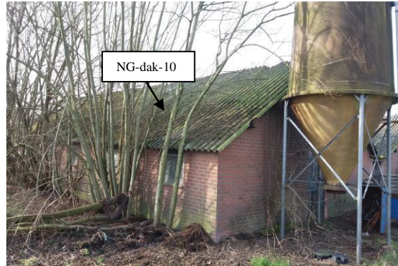
Foto 38: Geïntervieweerde schuur 9 met asbesthoudende golfplaat als dakbedekking vanuit zuidoostelijke richting gezien.
