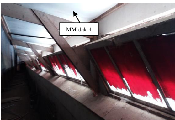
Foto 15: Asbesthoudend plaatmateriaal als dakbeschot van schuur 3. (betreft panelen van buitenaf toegepast)
