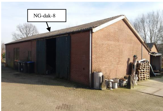
Foto 33: Geïventariseerde schuur 7 met asbesthoudende golfplaat als dakbedekking vanuit westelijke richting gezien.
