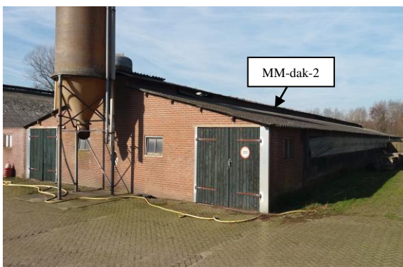
Foto 11: Geïntervieweerde schuur 3 met asbesthoudende golfplaat als dakbedekking vanuit zuidoostelijke richting gezien.
