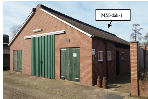
Foto 2: Geïntervieweerde schuur 1 met asbesthoudende golfplaat als dakbedekking vanuit zuidoostelijke richting gezien.
