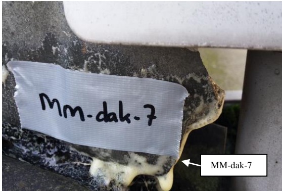
Foto 25: Asbesthoudende windveren t.p.v. verhoogd dak van schuur 6.
