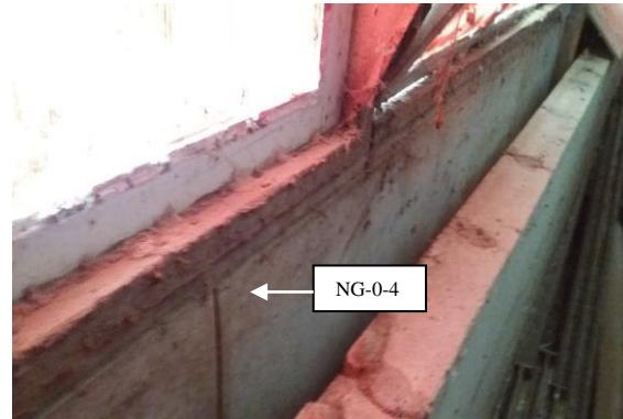
Foto 14 : Asbesthoudend plaatmateriaal als binnenwand van schuur 3. (betreft panelen van buitenaf toegepast)
