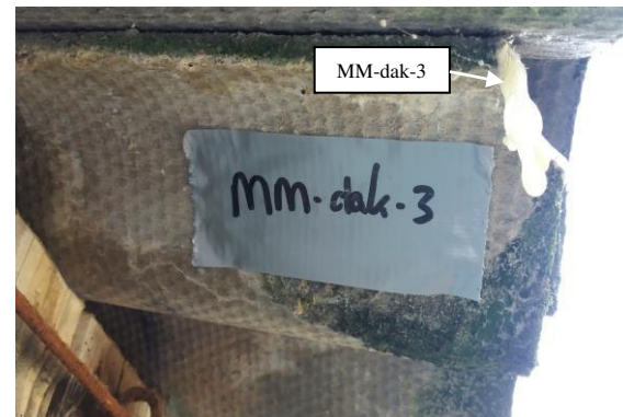
Foto 10: Asbesthoudende golfplaat als dakbedekking van schuur 3. (lage golf)
