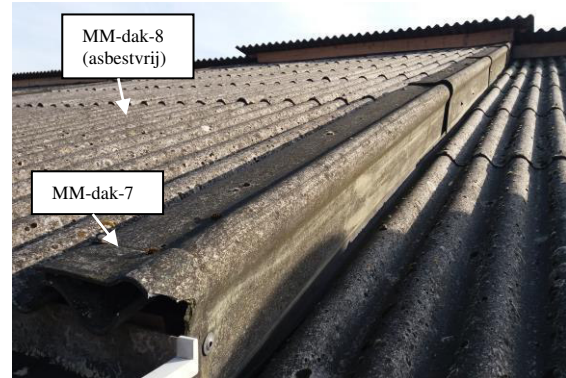
Foto 26: Asbesthoudende windveren t.p.v. verhoogd dak van schuur 6. Golfplaat als dakbedekking is asbestvrij. (zie foto 24 en 27)
