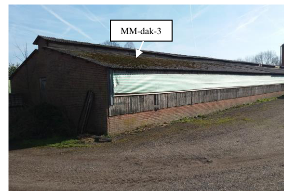
Foto 12: Geïntervieweerde schuur 3 met asbesthoudende golfplaat als dakbedekking vanuit noordwestelijke richting gezien.
