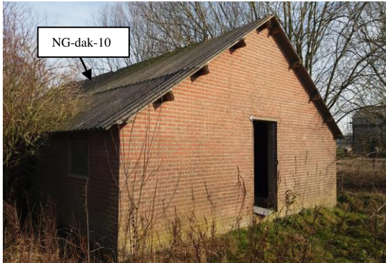
Foto 37: Geïntervieweerde schuur 9 met asbesthoudende golfplaat als dakbedekking vanuit westelijke richting gezien.
