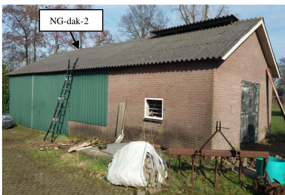
Foto 5: Geïntervieweerde schuur 2 met asbesthoudende golfplaat als dakbedekking vanuit zuidwestelijke richting gezien.
