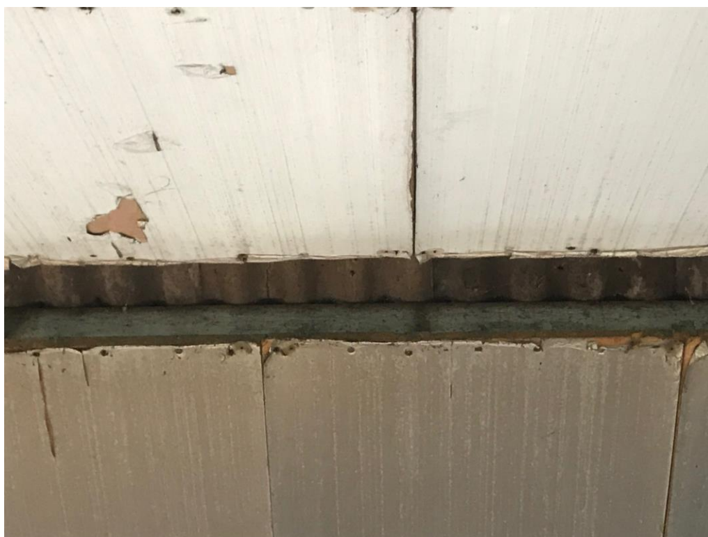
Figuur 4 Tussen het dak en isolatie materiaal is geen open ruimte aanwezig.
