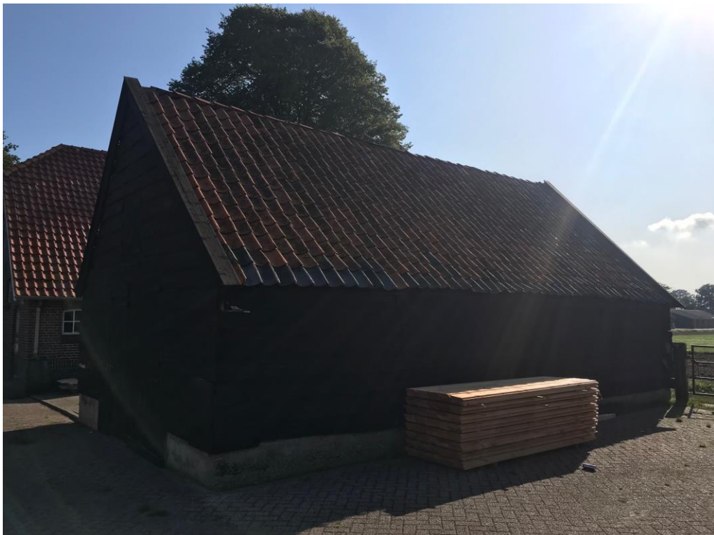
Figuur 2 De houten schuur met een schuin dakpannen dak welke gesaneerd zal worden.
