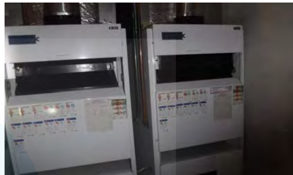
Hetelucht ketels niet asbestverdacht
