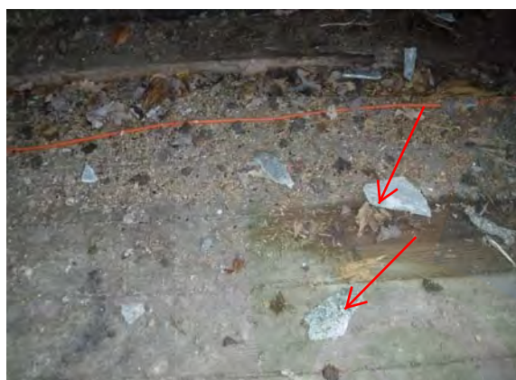
Asbesthoudende restanten op de vloer
