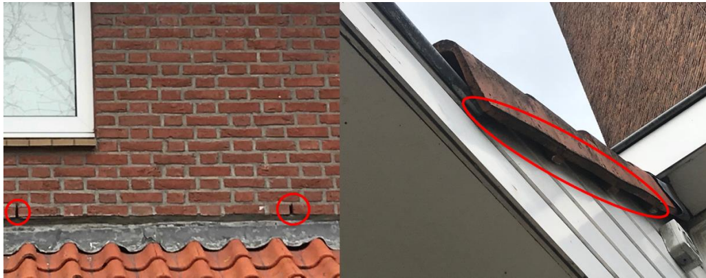
Figuur 3 Potentiële invliegopeningen voor vleermuizen in de kerk in de vorm van open stootvoegen (links) en overhangende kantpannen (rechts).
