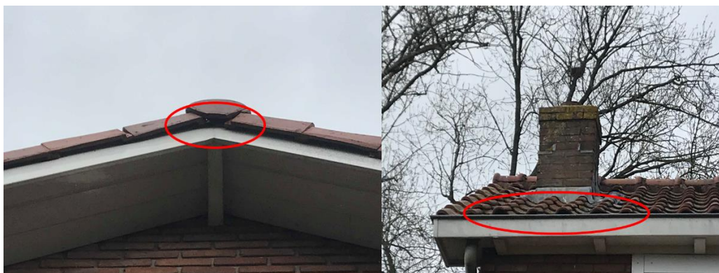
Figuur 2 Potentiële invliegopeningen voor vleermuizen in de woning in de vorm van overhangende kant- en nokpannen (links) en open dakpannen (rechts).
