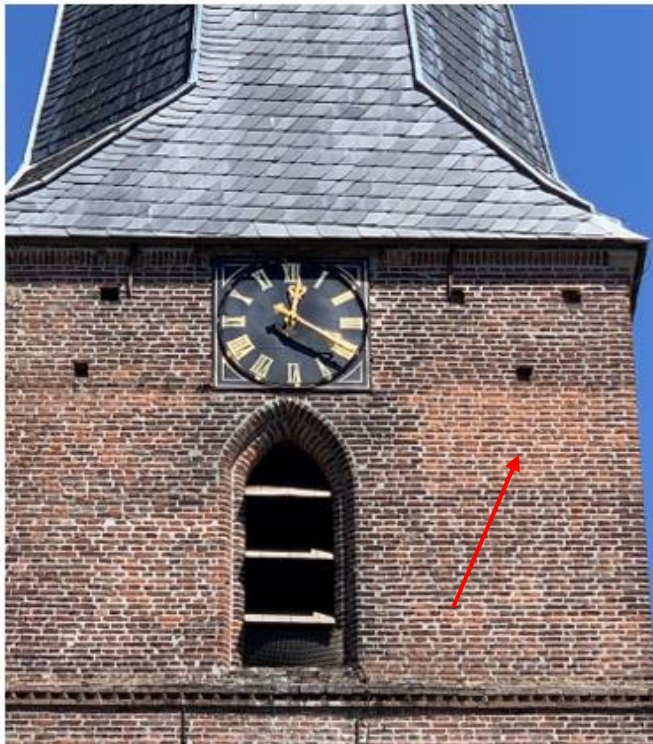
Figuur 14: Zichtbaar herstelde schade granaatinslag (rode pijl)
