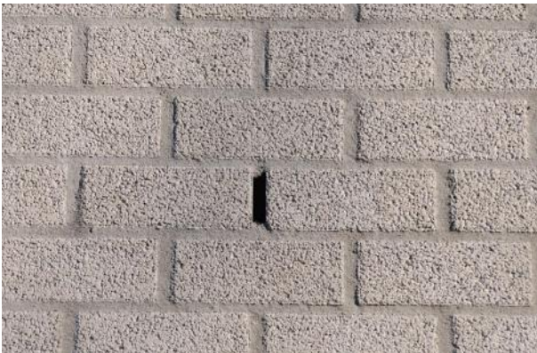
Figuur 18: Uitvoeringsvoorbeeld opening spouwmuur met open stootvoeg. Deze is alleen geschikt voor dwergvleermuizen. Voor grotere soorten dient een groter invliegopening gebruikt te worden (Bron: Ecogroen)
