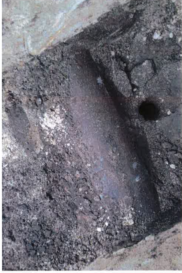
Berm 5, vermoedelijke asbestpijp
