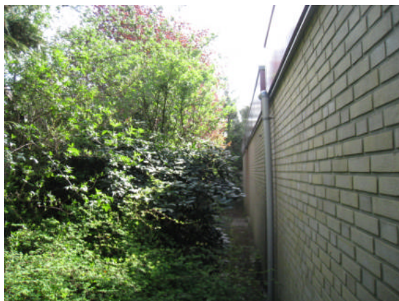
Foto 4: begroeiing dicht op de gevel
