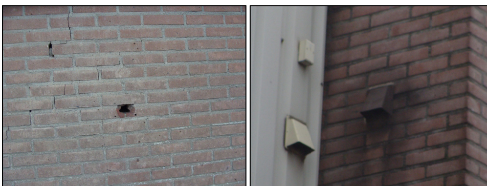
Foto's 5 & 6. Mogelijke toegang tot de gebouwen voor vleermuizen.
