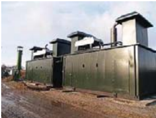
De containers met de gasmotoren. (4)
