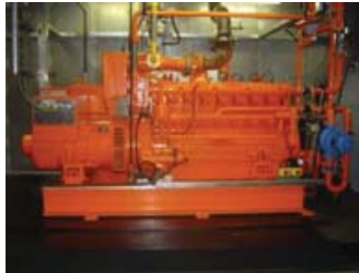
Blik in de container. De gasmotor met generator. (4+6)
