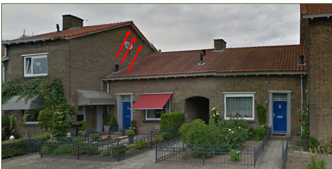
A. Kluitstraat nr. 23, gaten bovenzijde muur.
