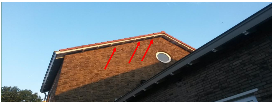
A. Kluitstraat nr. 34, gaten bovenzijde muur.
