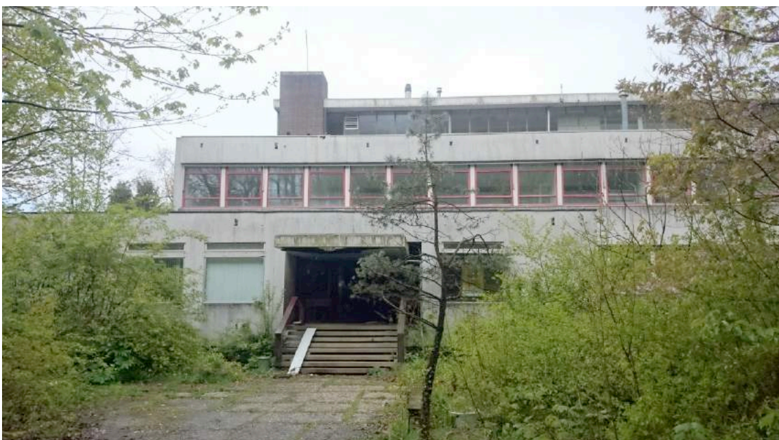
Gevelaanzicht oostelijke kantoorgebouwkantoorgebouw. Hoewel gaten in de gevels aanwezig, zijn er
