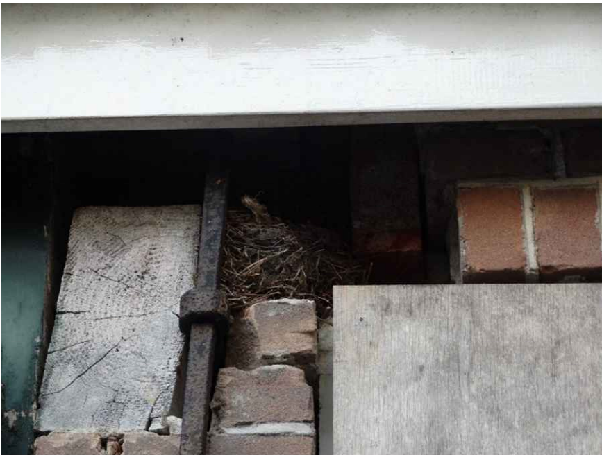
12 Nest in opening tussen muur en dak.
