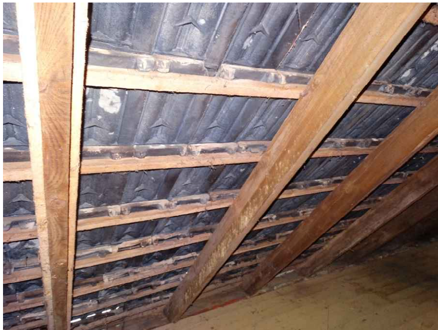
10 Geen dakbeschothout aanwezig bij de rest van het dak, boven de voormalige stallen
