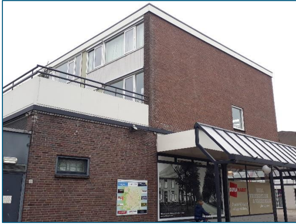
Figuur 4-3. De muur aan de oostzijde van de Dekamarkt. Hier zijn geen stootvoegen aanwezig. Net boven de afscheiding (plafond) die de Dekamarkt van de woningen erboven scheidt zitten wel stootvoegen. Door deze afscheiding is echter duidelijk dat een eventuele spouw in de muur van de Dekamarkt niet in verbinding staat met de buitenmuur van de bovenwoningen.
