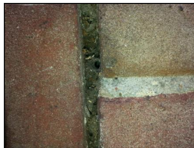
Figuur 11. Detailfoto open stootvoeg, niet toegankelijk voor vleermuizen.
