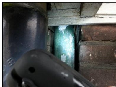
Figuur 10. Verborgen ruimte rond regenpijp.
