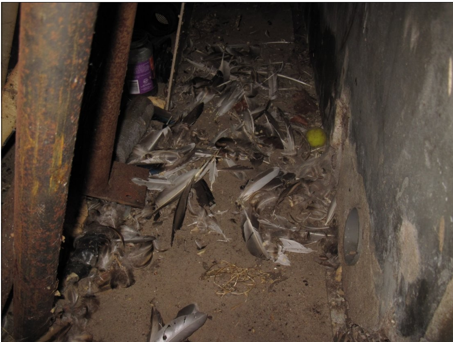
Afgebeten veren in gebouw F.
