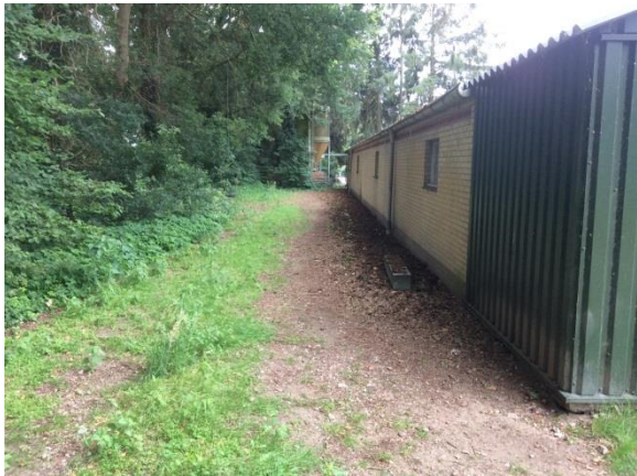
Figuur 8: Dakgoot bebouwing oostzijde
