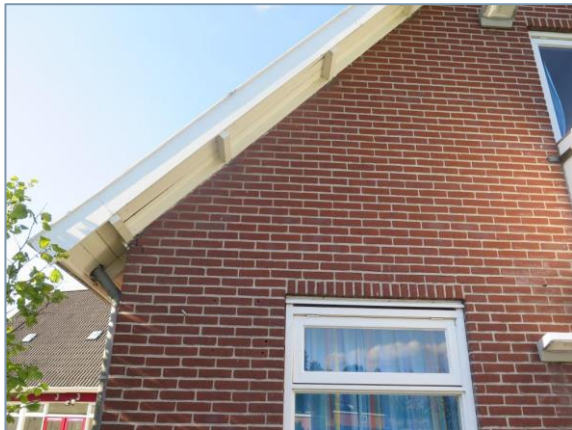
Foto 5. Geen ruimte tussen de muur en dakomlijsting.
