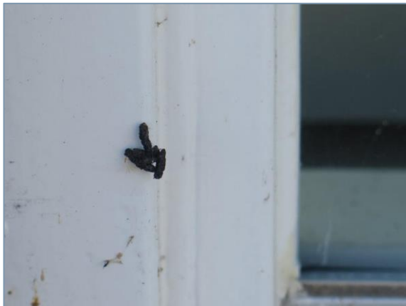
Foto 3. Vleermuiskeutels op raamkozijn hoofdgebouw.
