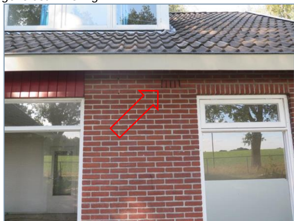
Foto 8. Open stootvoeg (rode pijl) in één van de bijgebouwen.
