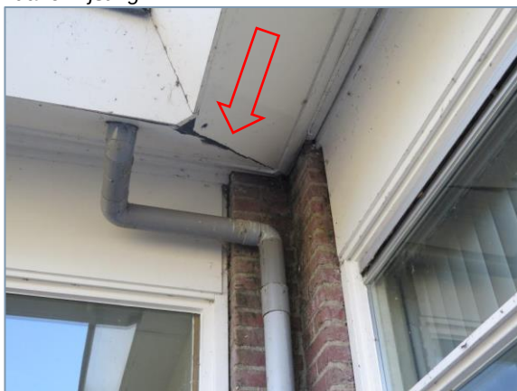
Foto 7. Kier (rode pijl) in dakoverschot hoofdgebouw.
