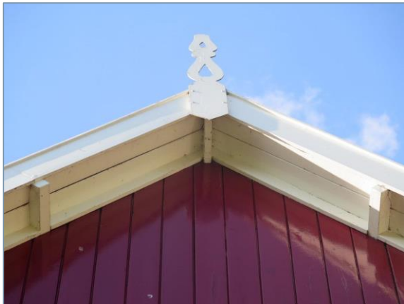
Foto 6. Geen ruimte tussen de dakomlijsting en de gevelbetimmering.
